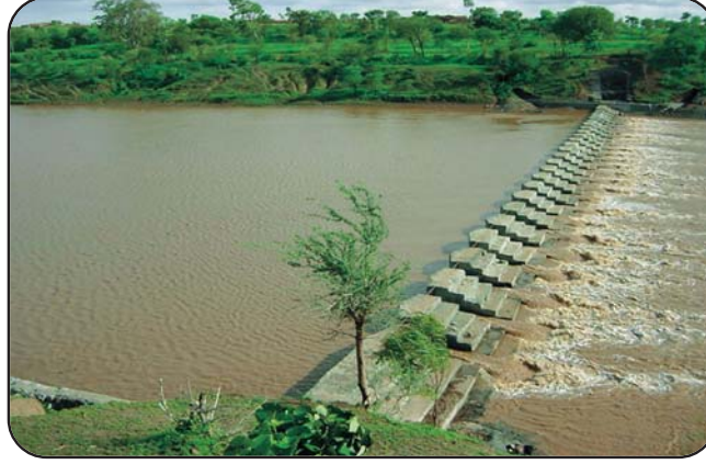
परियोजना क्षेत्र में निर्मित बाँध का एक दृश्य। A view of Check Dam constructed in the project area.
